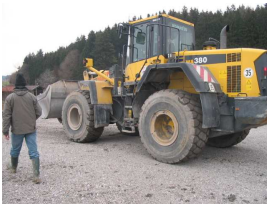
Ein letztes Mal wird vor dem Überbau der Schlacke ein Proof Rolling durchgeführt
